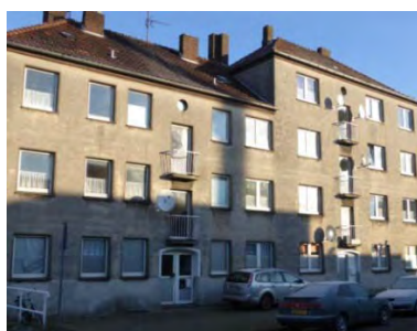
Gebäude mit hohem Investitionsstau
